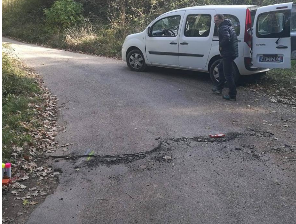
Deux jours après le séisme du Teil, des chercheurs, dont le paléosismologue Jean-François Ritz se sont rendus sur place. Pour eux, il ne fallait pas manquer cette opportunité d'observer une rupture de surface. Photo DR
