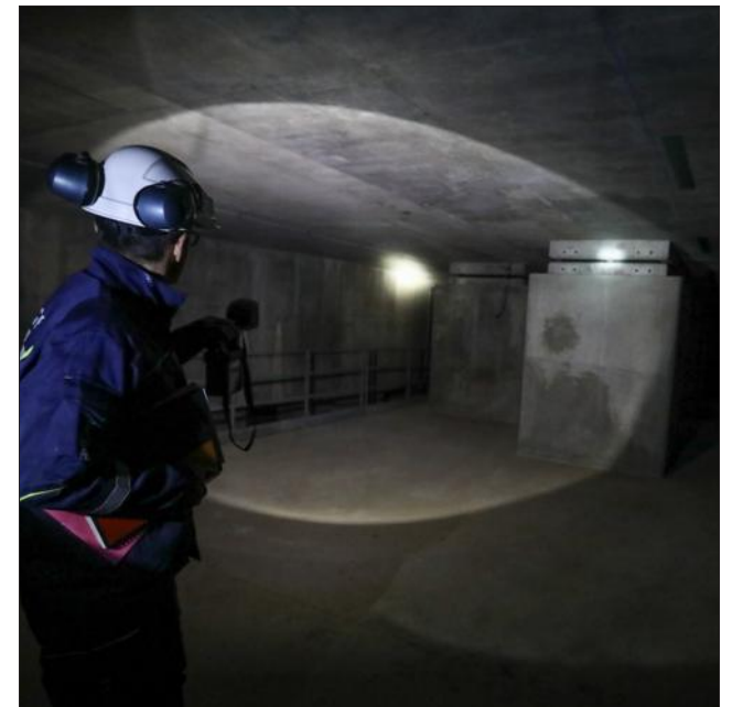
Sous des plots antisismiques à la centrale nucléaire de Cruas-Meysses en Ardèche. Photo Le DL/Fabrice ANTERION
